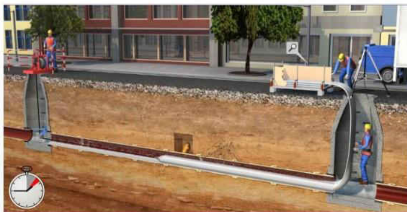
Figura III. 1 Instalación de la manga de fibra de vidrio en la tubería a través de un pozo de visita existente.
