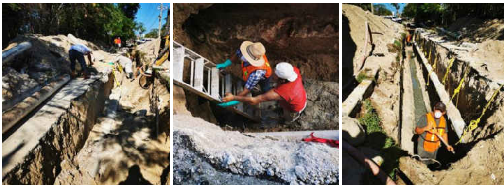
Figura II. 8 Trabajos de localización, desazolve y retiro de material producto del colapso en el colector Rafael E. Melgar.
