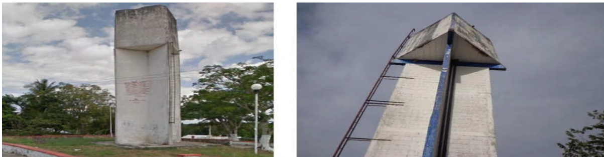
Figura II 4 Tanques elevados de 10 y 25 m 3 de capacidad de la localidad de Caobas
