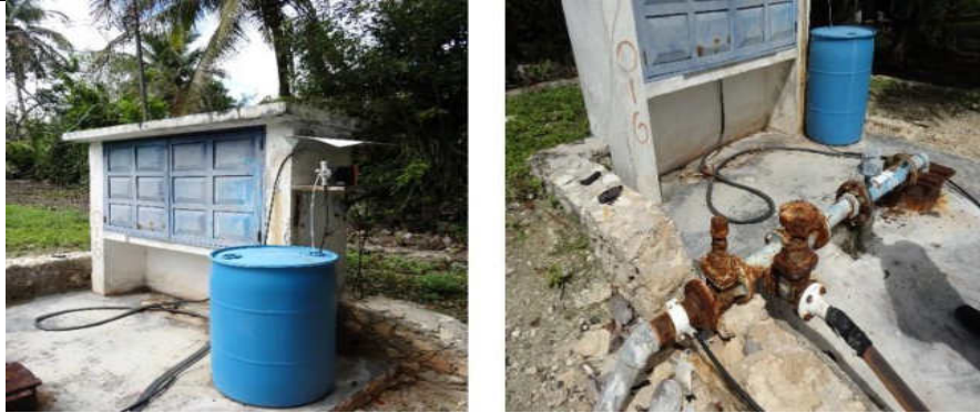
Figura II 3 Zona de captación de la localidad de Caobas
