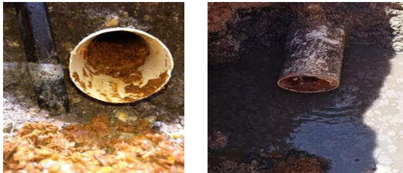
Figura II 6 Red de distribución con acumulación excesiva de sarro.
