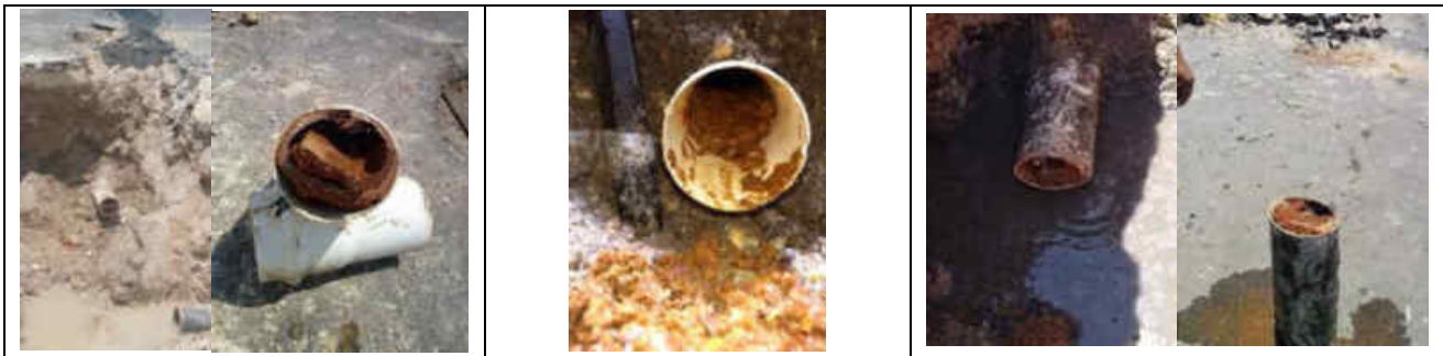
Figura II. 27 Fotos de tuberías de la red de distribución con taponamientos por acumulación de sarro.
