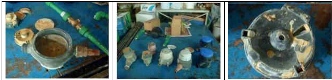
Figura II. 7 Condiciones de los Medidores domiciliarios.
