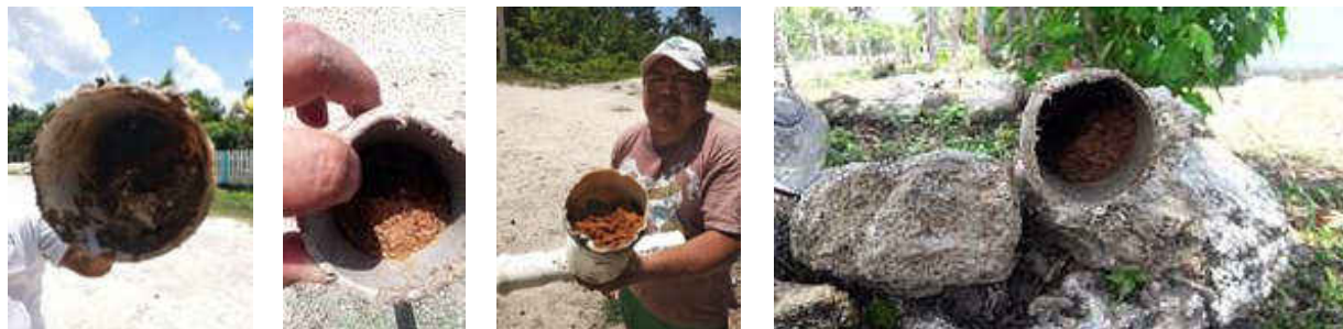
Figura II. 8 Incrustaciones y taponamientos en tuberías del sistema Calderitas.
