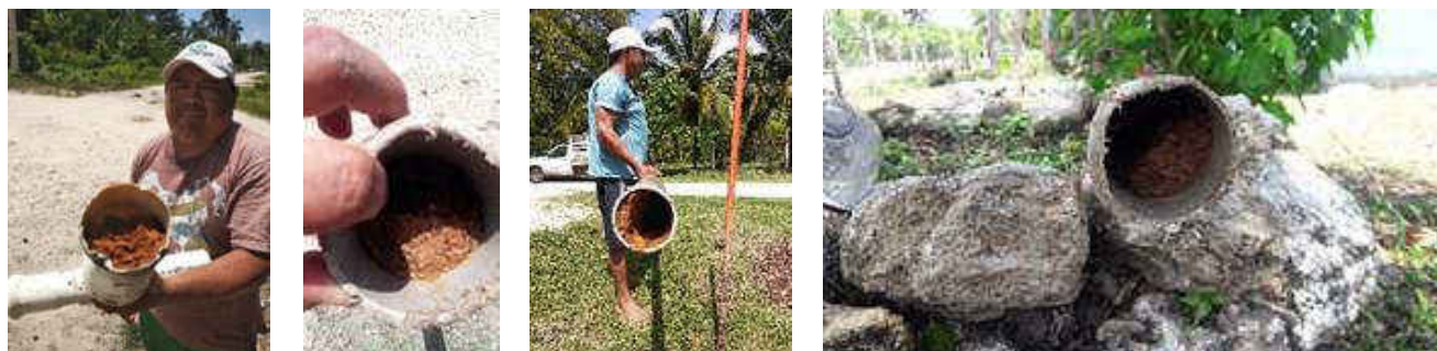
Figura II. 21 Fotos de tuberías de la red de distribución con taponamientos por acumulación de sarro.
